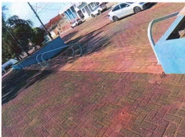
Foto 1 – Acesso à Casa do Papai Noel, onde se faz necessária a instalação de rampa de acessibilidade.
